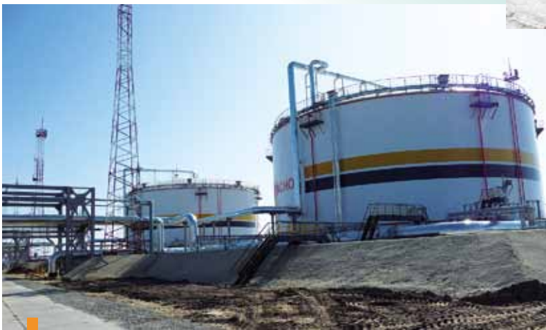
Конечная нефтеперегонная станция, резервуар вертикальный стальной на объекте Морской торговый порт в г. Усть-Луга (ОАО «ЧСУ «Термостепс»).
