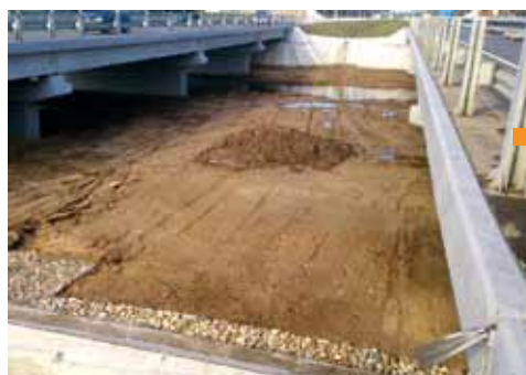
Реконструкция автомобильной дороги А-114м: строительство моста через р. Ягорбу (ООО «Мостостроительный отряд № 61»).
