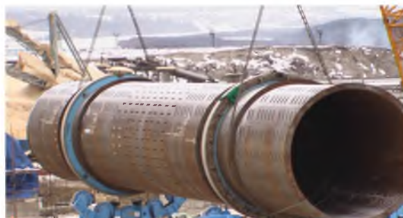
МОНТАЖ ОБЕЧАЙКИ ОКORОЧНОГО БАРАБАНА ДИАМЕТРОМ 6М (АО МОНДИ) Адрес: республика Коми, г. Сыктывкар
