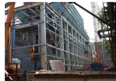
Установка улавливания неорганизованных выбросов от конвертеров. ПАО «Северсталь», сталеплавильное производство. АО «КХМ-2»
