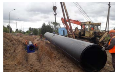
Капитальный ремонт тракта водоподачи из Кубенского водохранилища на реке Вологда вблизи деревни Михальцево ООО «Спецмонтажстрой»
