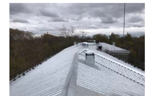
Капитальный ремонт крыши многоквартирного дома, г. Сокол, ул. Советская, д. 45 ООО «ПрофЛесСтрой»
