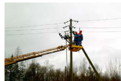
Рамена трансформаторов тока в Пункте коммерческого учета, установленного на опоре ВЛ-10кВ фидер «СХТ», Устье АО «Вологодская Областная Энергетическая Компания»
